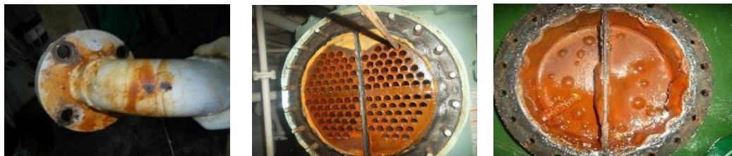
Gambar 1.1 Pipa bocor & pipa kondensor kotor. (sumber: dokumentasi kapal)
