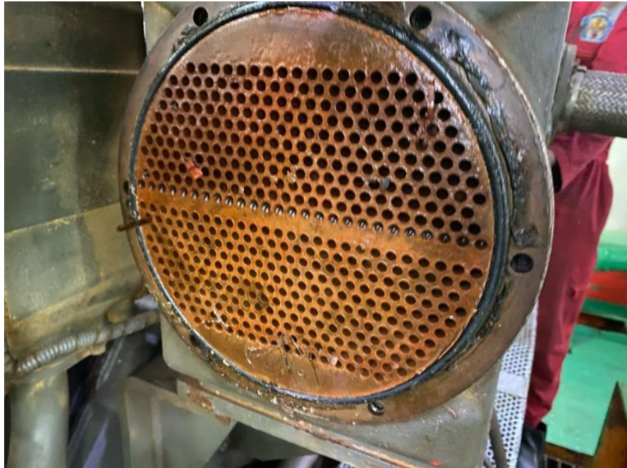
Gambar 2.4 : Fresh water cooler Dari Samping Dokumentasi Pribadi
