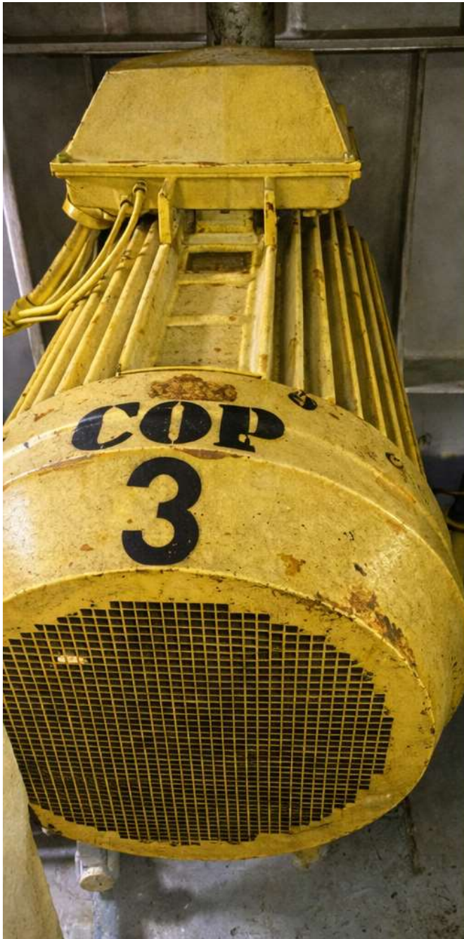
Lampiran 2 Cargo Oil Pump pada MT. Katomas
