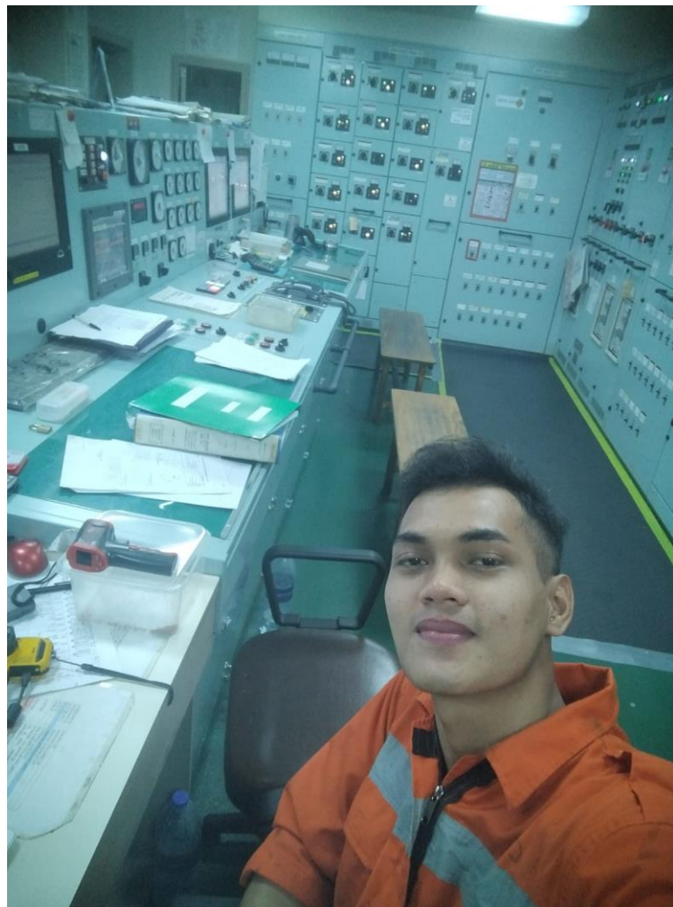
Kondisi ECR (Engine Control Room)
