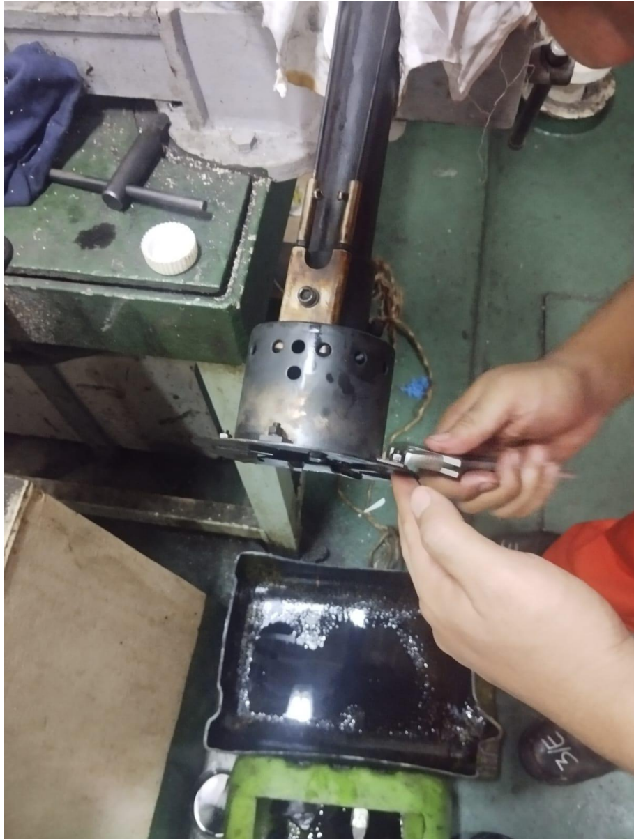
Pemeriksaan pada Main Burner Boiler
