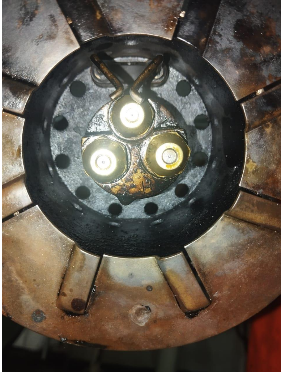
Nozzle Main Burner setelah dibersihkan
