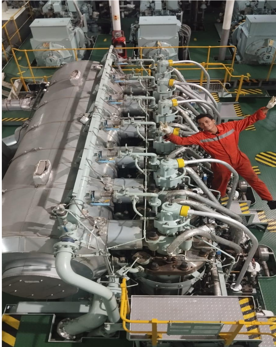
Dokumentasi penulis di ruang mesin
