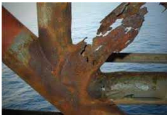
Gambar 2.9 Fatigue corrosion (korosi lelah)
